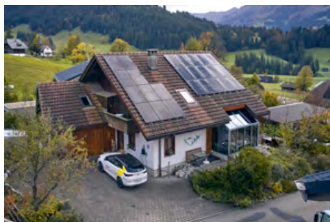
La centrale sur le toit dispose d'une puissance de 25,62 kilowatts-crête.
